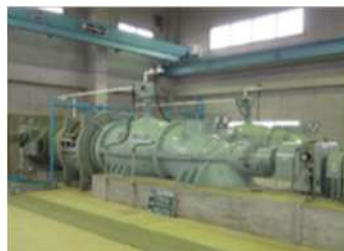
内部の排水ポンプ
