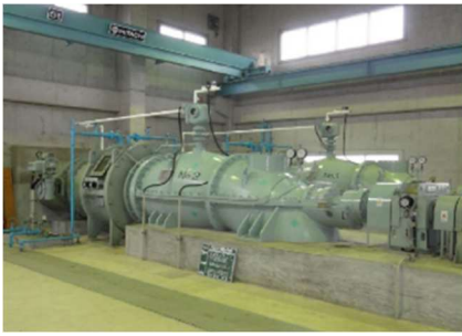
久保田第2排水機場 内部の排水ポンプ
